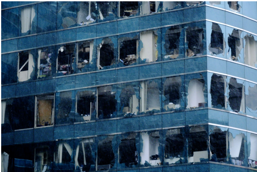
Die Schlagkraft des Taifuns Mangkhut: Beschädigte Fassade eines Bürogebäudes in Hongkong. Wang Shen/Xinhua/AP Photo
