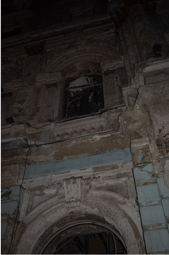
Schäden nach einem Bombenangriff im historischen Zentrum von Charkiw.
